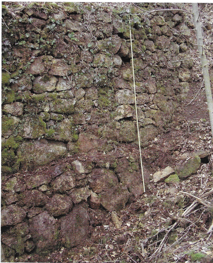
Le mur de soutènement du chemin creux ouest appareillé de blocs de poudingue mesure trois mètres de haut.
