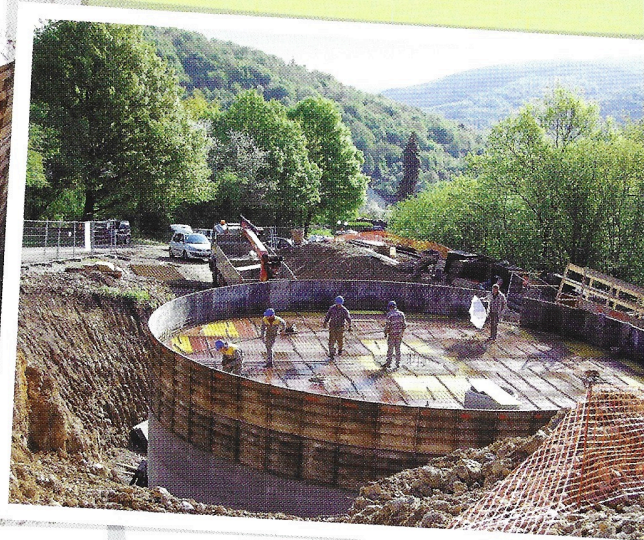
Le nouveau réservoir d'eau potable d'une capacité totale de 500 m 3 mis en service en décembre 2009.
